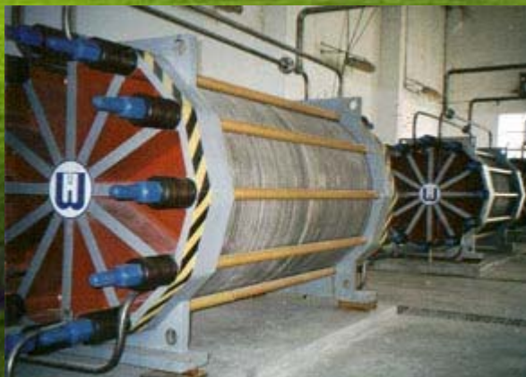
電解槽製氫設備
