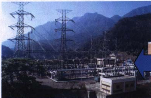
開關場及輸電鐵塔
